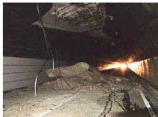
トンネルの崩落
