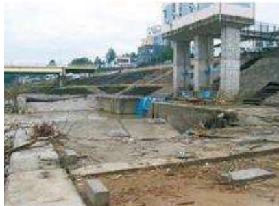
水門低水護岸の破損
